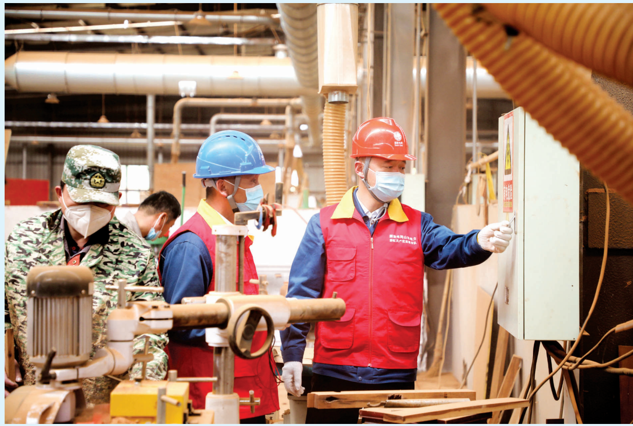
国网济宁供电公司跟踪服务产业园区用电需求,把供电服务网点驻扎园区,“一对一”精准化服务,定期上门把脉式“问诊”入驻企业生产经营情况、用电负荷、设备运行情况,并帮助排查用电安全隐患,保障企业用电安全可靠,助力企业发展壮大。图为4月15日,梁山县供电公司彩虹党员服务队队员到梁山家居产业园区内企业上门服务。
