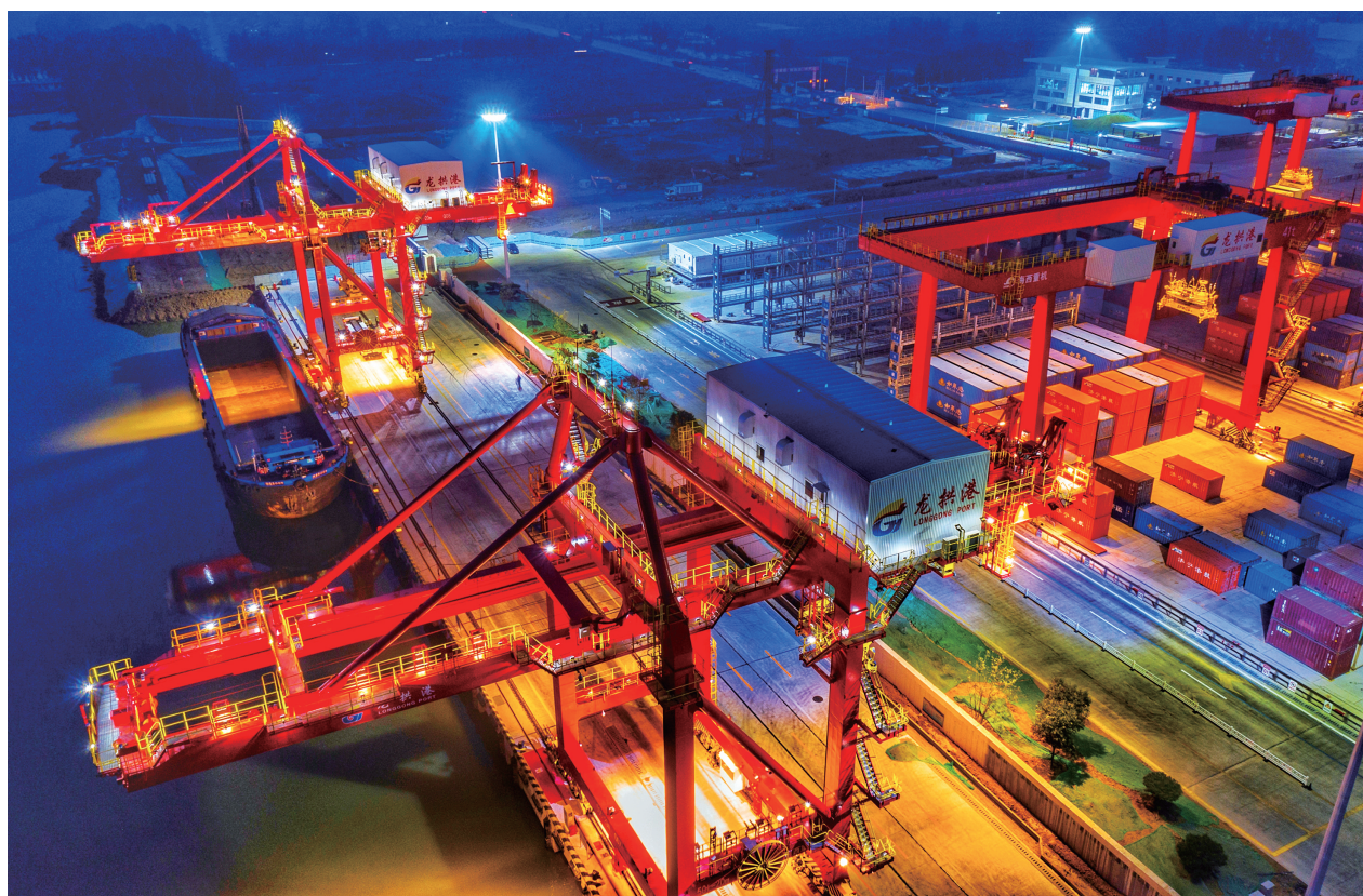
近日夜间，济宁能源龙拱港8#号自动化集装箱泊位正紧张进行联调联试，一片繁忙景象。据了解，龙拱港二期是省重点基础设施项目、省2022年重大项目，港口岸桥、场桥、无人集卡等设备采用自动化操控技术，使用光纤+5G的双路由通信控制，作业效率比传统方式提升80%，达到国内领先水平。 ■记者 杨国庆 通讯员 马辉 摄
