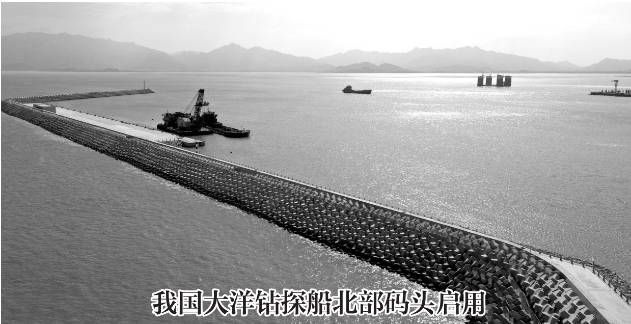
5月6日拍摄的中国地质调查局大洋钻探船北部码头(无人机照片)。当日，自然资源部中国地质调查局大洋钻探船北部码头在山东青岛揭牌。该码头位于青岛市即墨区柴岛西侧，是我国深海探测“国之重器”——大洋钻探船的母港之一，具备船舶停靠、备航补给、指挥调度、维修保养等功能。 ■新华社发 梁孝鹏 摄
