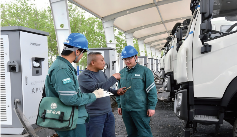
国网济宁供电公司员工在重卡充电站开展用电安全宣传。
