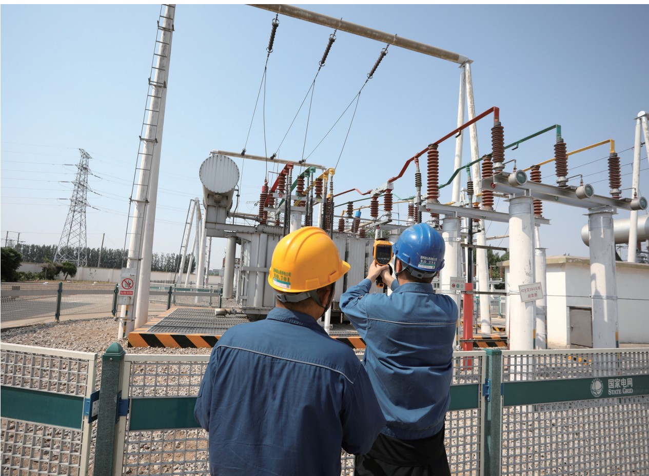
为保证高温下电网安全可靠运行,梁山县供电公司结合夏季电网负荷、设备负载和气候变化等情况,开展迎峰度夏电网运行安全隐患和薄弱环节排查。7月1日,梁山县供电公司员工对110千伏梁西变电站开展巡视测温,密切关注高温天气下设备运行情况,及时排查消除安全隐患,进一步提升电网设备健康运行水平,全力保障周边客户夏季安全可靠用电。
