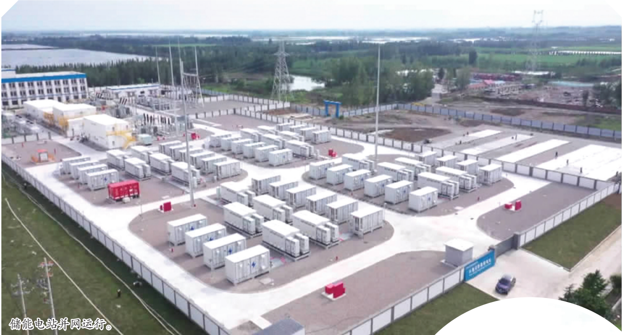
储能电站并网运行。
